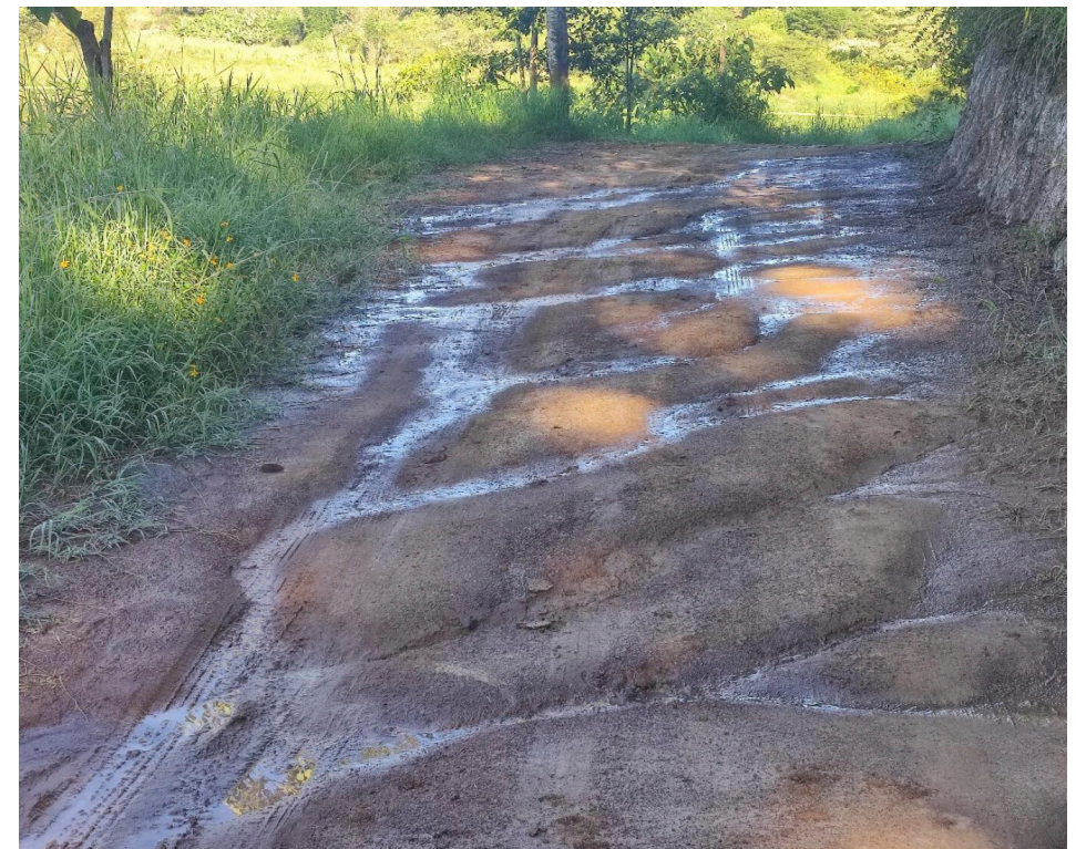
Figura 14. Escurremientos que cruzan el camino. A la derecha se aprecia la ladera que ha sido cortada en vertical para hacer la sección horizontal de la brecha. Los escurrimientos producen encharcamientos, y el agua sigue su camino hacia abajo para finalmente encontrarse con el espejo de agua.
