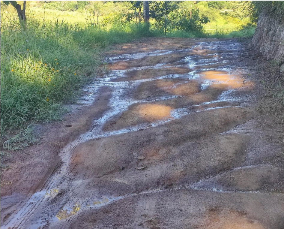
Figura 14. Escurremientos que cruzan el camino . A la derecha se aprecia la ladera que ha sido cortada en vertical para hacer la sección horizontal de la brecha. Los escurrimientos producen encharcamientos, y el agua sigue su camino hacia abajo para finalmente encontrarse con el espejo de agua.
