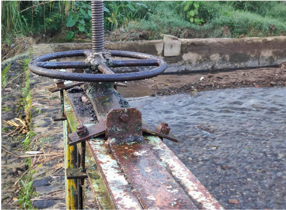
Figura 6. Instalación hidráulica en el río La Palma. Compuertas y esclusas levantadas en el lecho del río La Palma que permiten controlar el abastecimiento de agua de la laguna castillense, así como su decurso hacia el mar.
