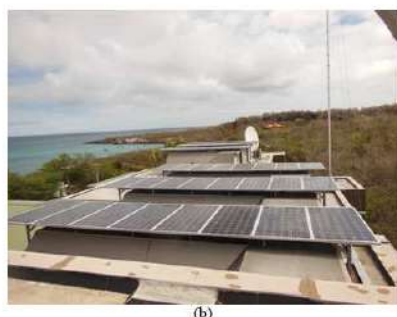
Figura 1: (a) infraestructura de generación eléctrica en las Islas Galápagos y localización del Campus de la Universidad San Francisco de Quito (USFQ Galápagos), (b) fotografía del SPS instalado en el edificio de la USFQ Galápagos (Autor: Sr. Luis Tasipanta).
